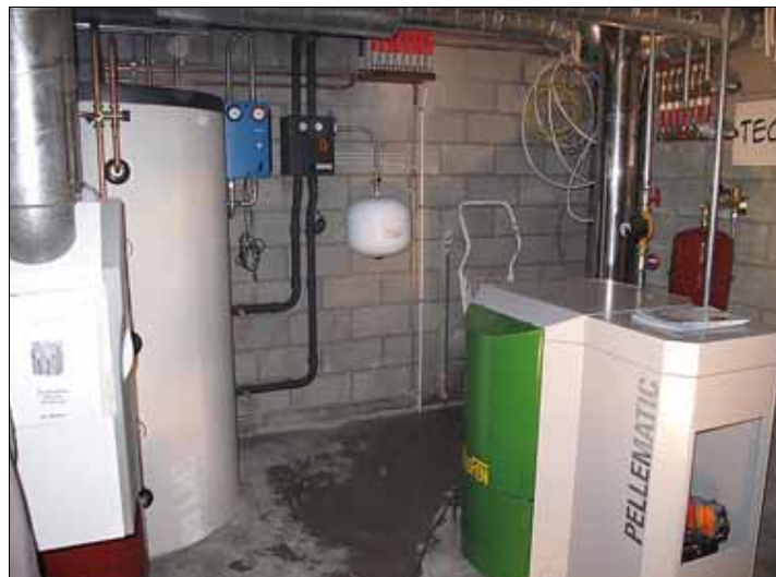
Een verwarmingsinstallatie die met houtpellets werkt
