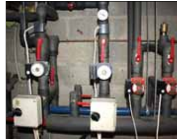
Didactische installatie in het bedrijf
