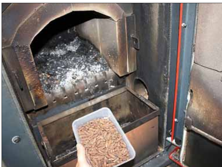
Verwarmingsketel voor verschillende brandstoffen die met dadelpitten werkt
